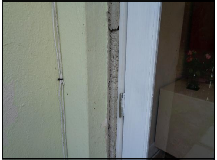
Missing Door Jamb
