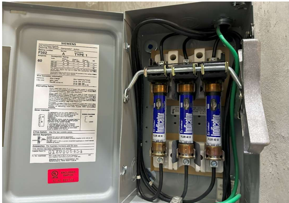
EM Transformer Disconnect -
