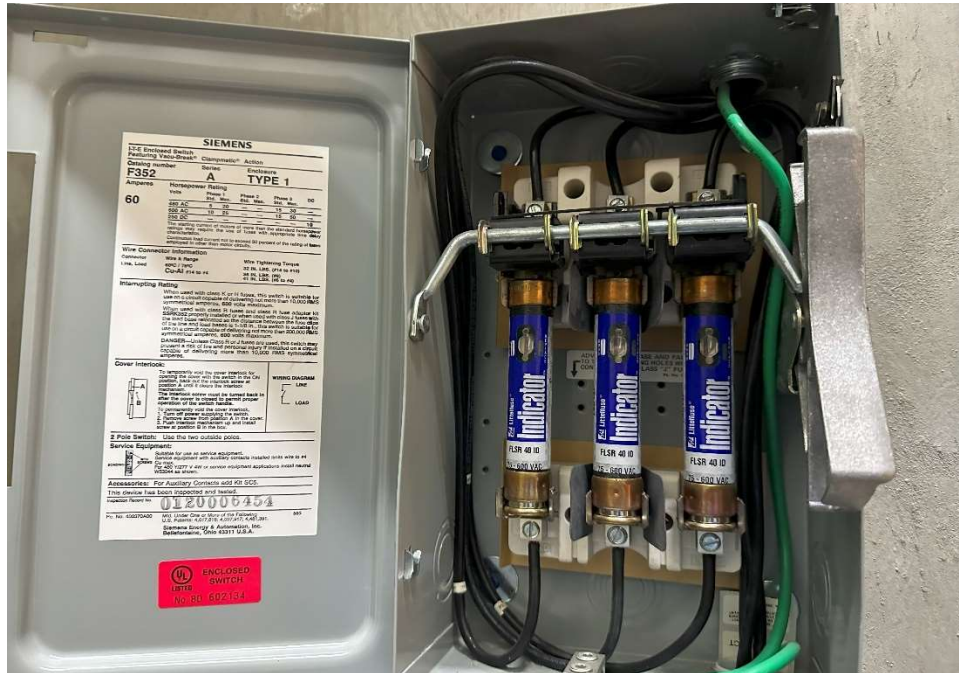
EM Transformer Disconnect -
